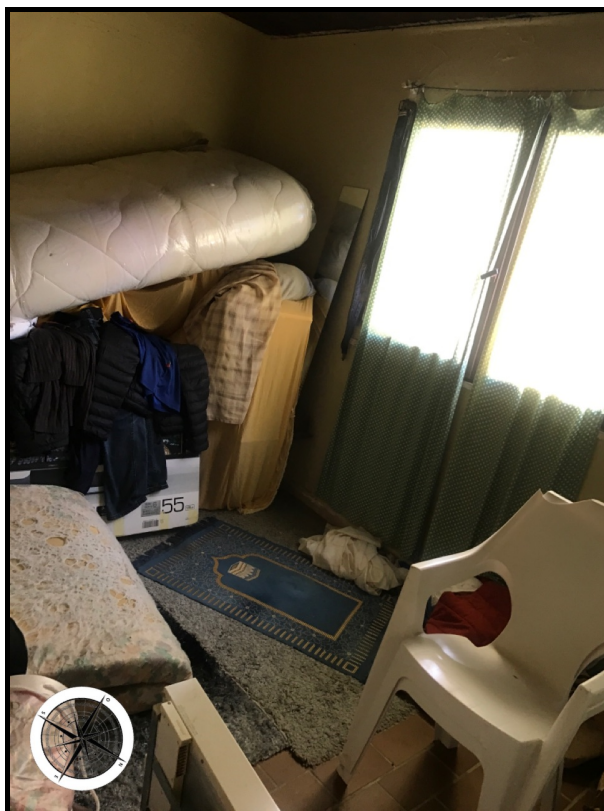
Photographie n°160. Chambre 2: sommaire: mauvais état
