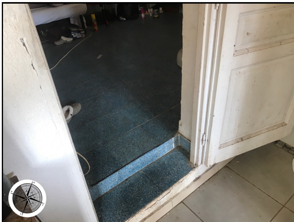
Photographie n°176. Chambre 1: accès : porte de communication peinte en blanc, en mauvais état
