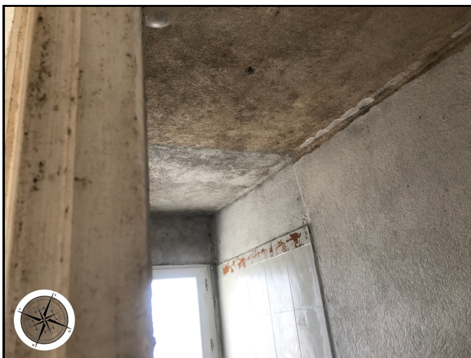
Photographie n°173. Salle d'eau et wc: murs et (plafonds en mauvais état);
