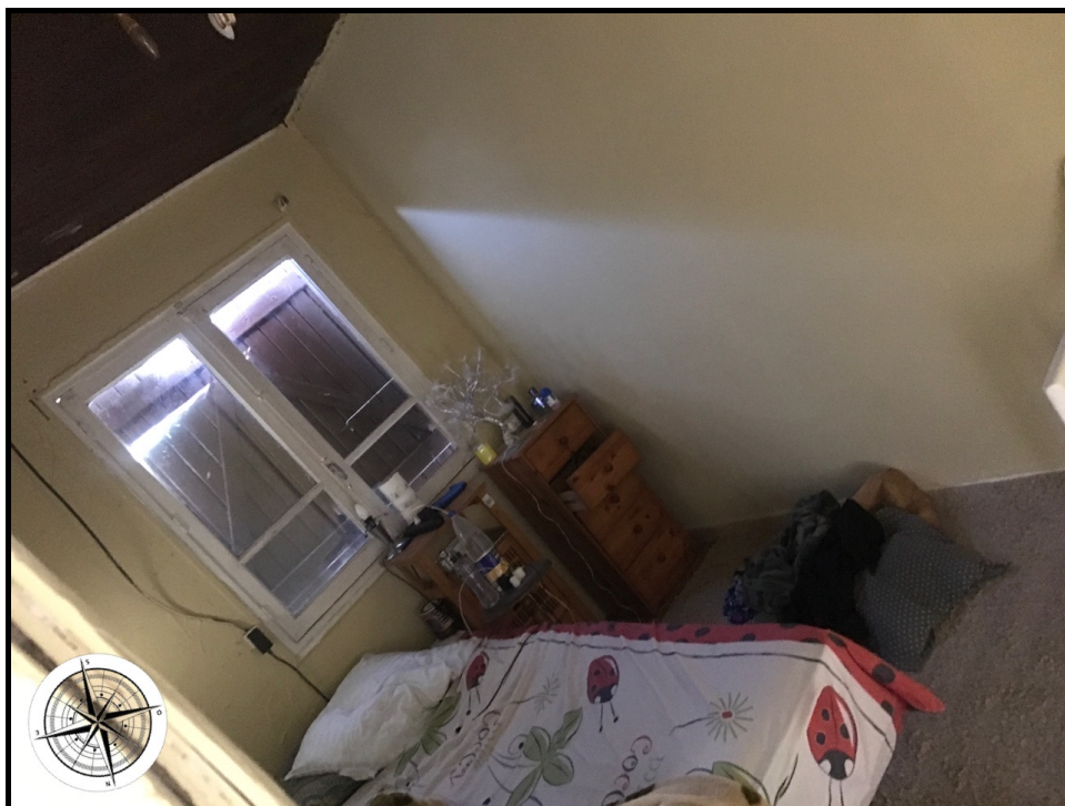
Photographie n°158. Chambre 1: sommaire. Mauvais état
