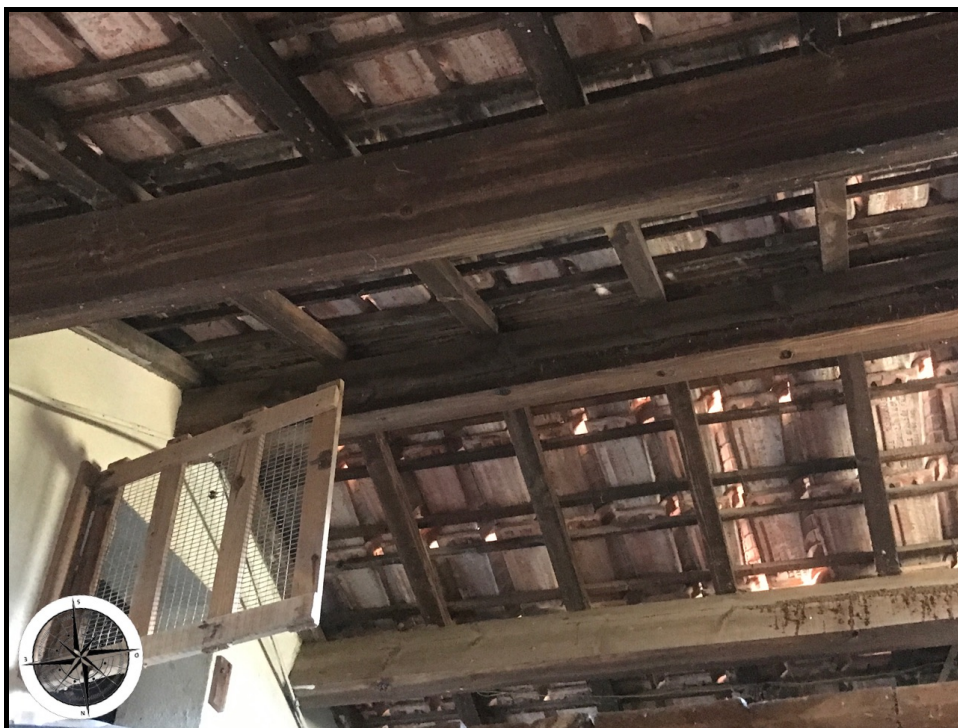
Photographie n°58. Vue generale : état du garage : vue toit: très nombreux ajouements
