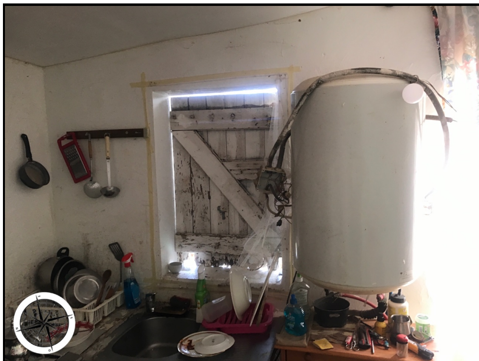
Photographie n°114. Chambre de dépendance : cumulus et huisserie extérieure bois en mauvais état
