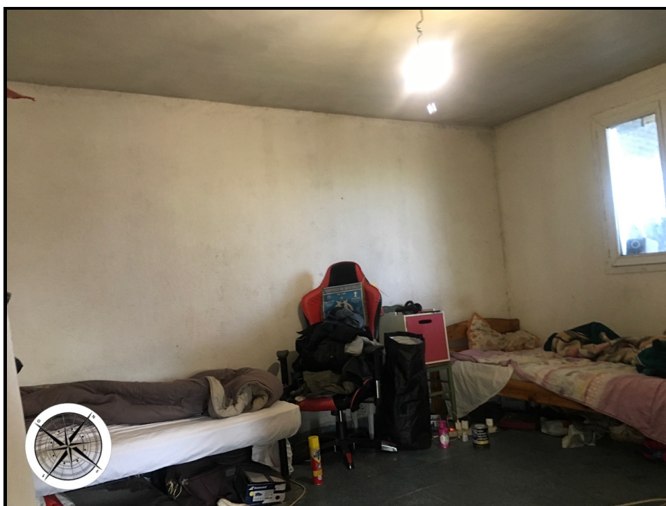
Photographie n°179. Chambre 1: sol: carrelage bleu en mauvais état
