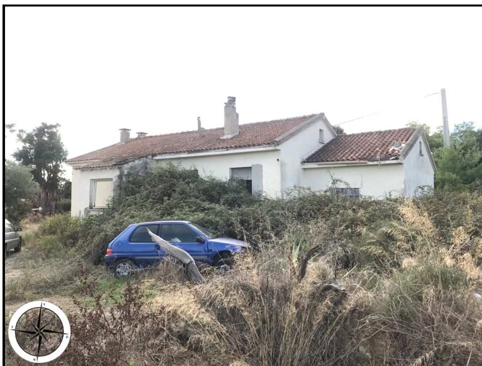
Photographie n°11. Villa non- hors d'air à l'état de ruine. Bien n°1
