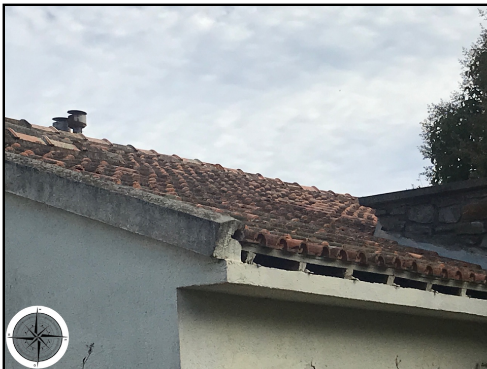
Photographie n°24. Villa non- hors d'air à l'état de ruine. Bien n°1: vue toit
