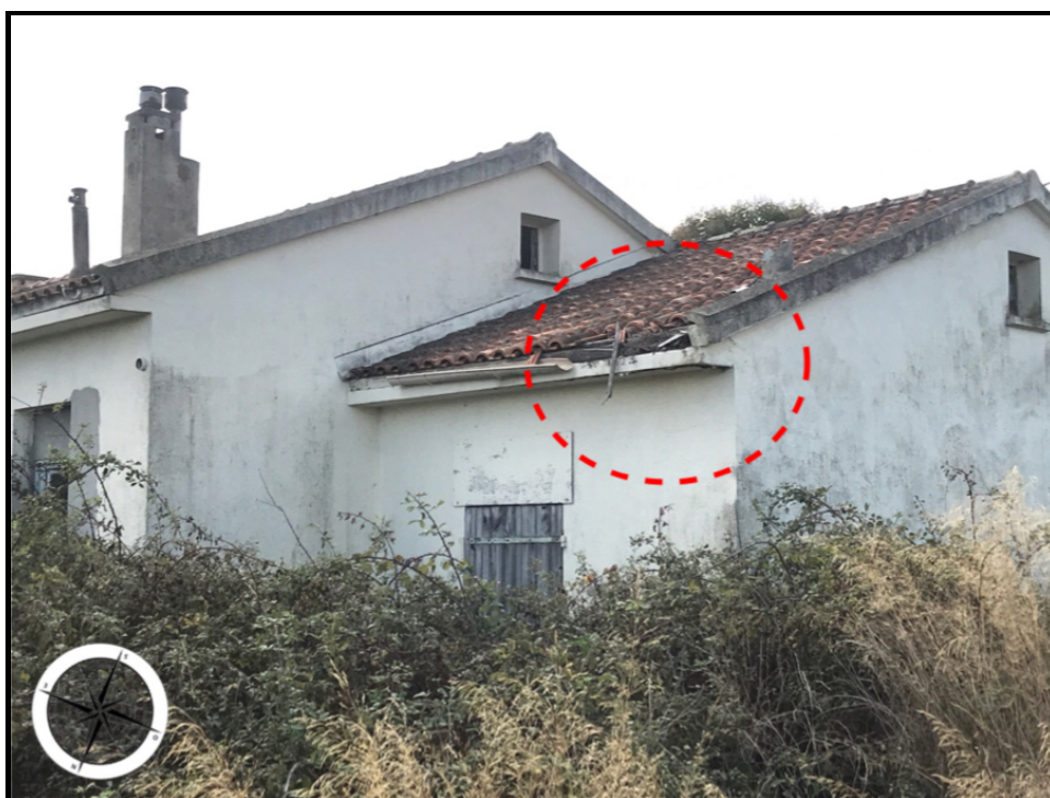
Photographie n°21. Villa non- hors d'air à l'état de ruine. Bien n°1
