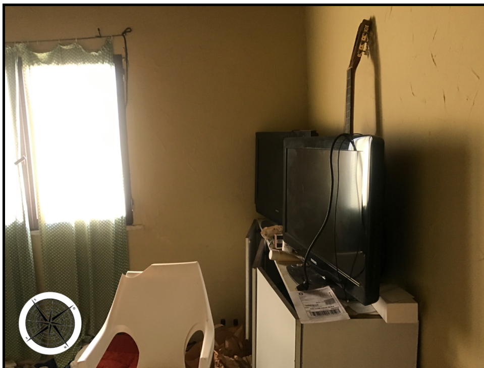
Photographie n°162. Chambre 2: sommaire: mauvais état
