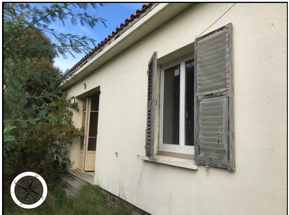
Photographie n°7. Villa non- hors d'air à l'état de ruine. Bien n°1
