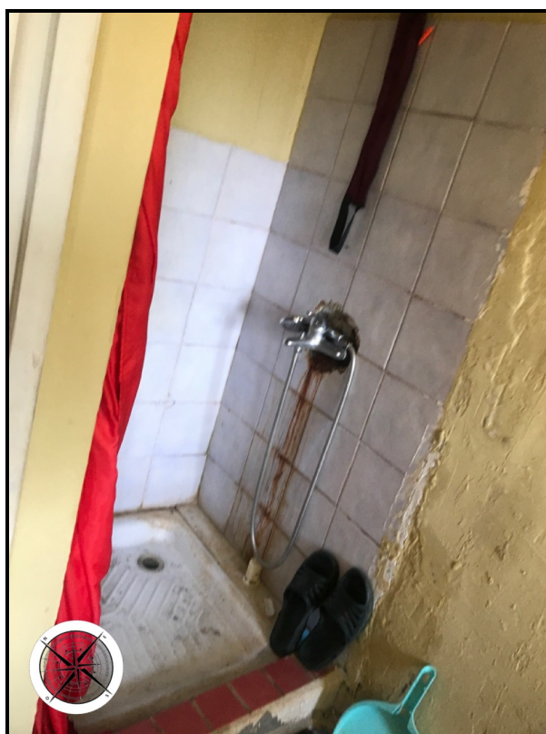
Photographie n°155. Salle d'eau et WC: mauvais état
