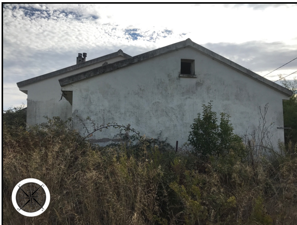
Photographie n°22. Villa non- hors d'air à l'état de ruine. Bien n°1
