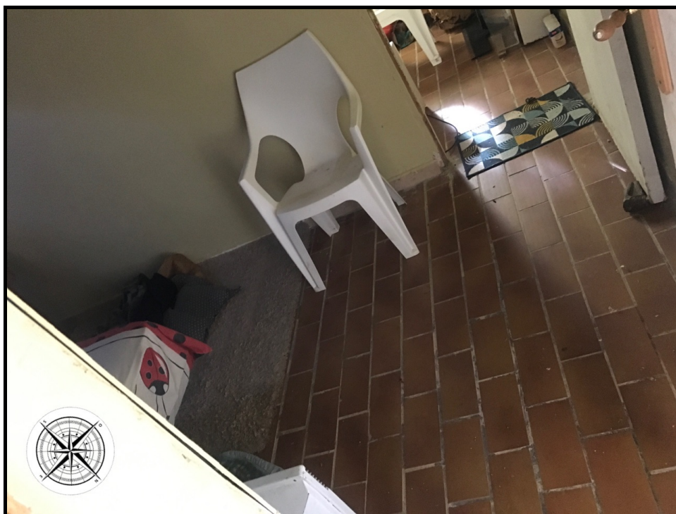
Photographie n°157. Chambre 1: sommaire. Mauvais état
