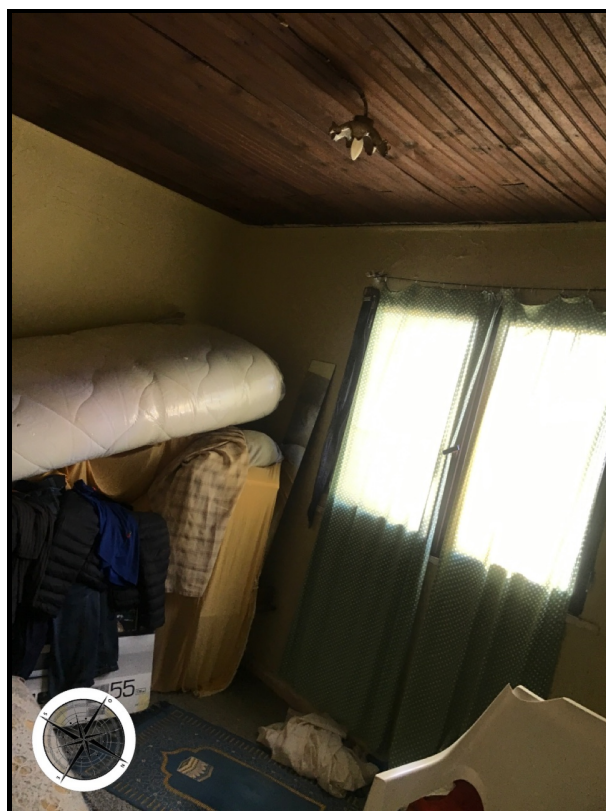
Photographie n°161. Chambre 2: sommaire: mauvais état
