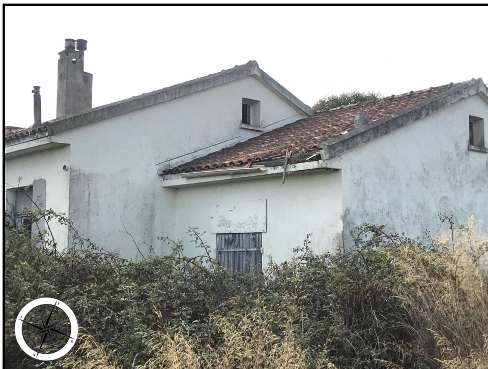
Photographie n°20. Villa non- hors d'air à l'état de ruine. Bien n°1
