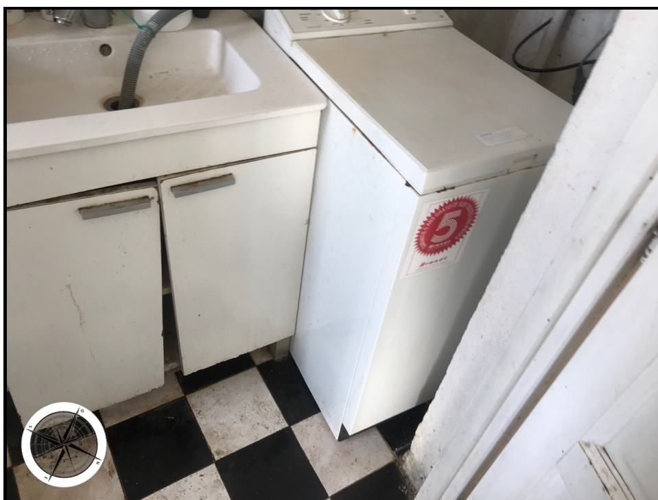
Photographie n°175. Salle d'eau et wc: évacuation et alimentation machine à laver
