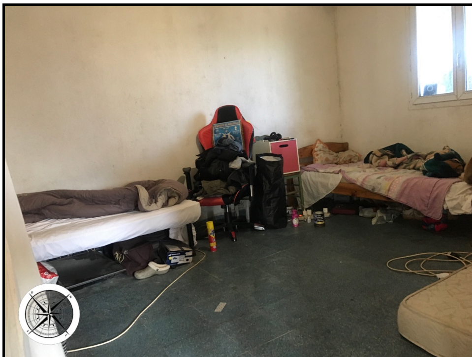
Photographie n°178. Chambre 1: sol: carrelage bleu en mauvais état
