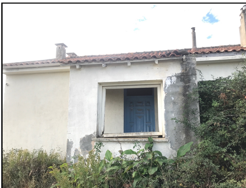
Photographie n°25. Villa non- hors d'air à l'état de ruine. Bien n°1
