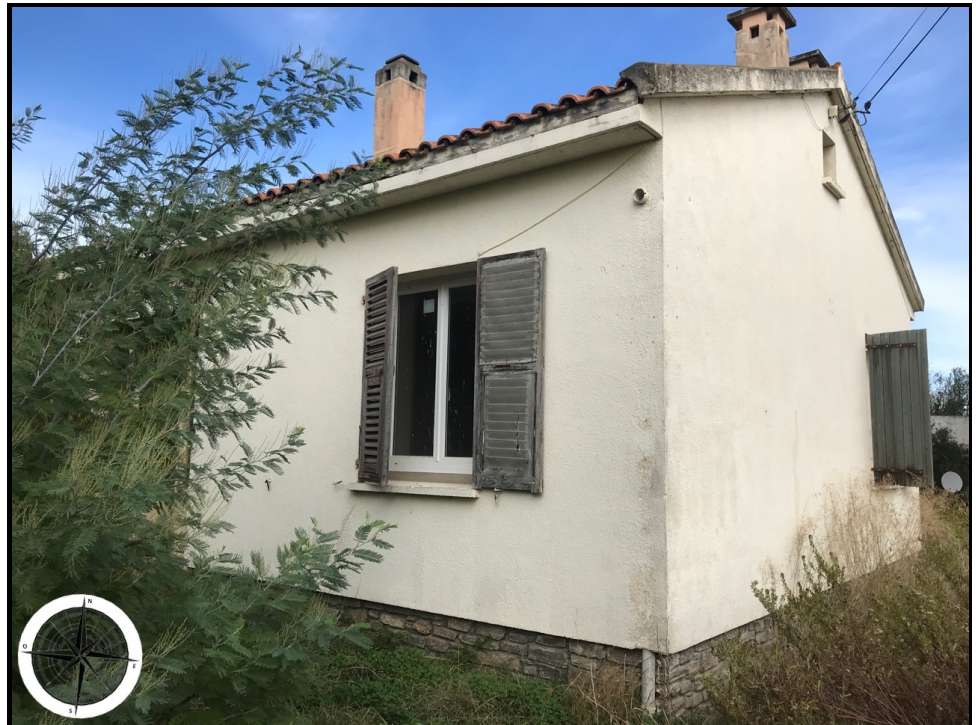
Photographie n°6. Villa non- hors d'air à l'état de ruine. Bien n°1
