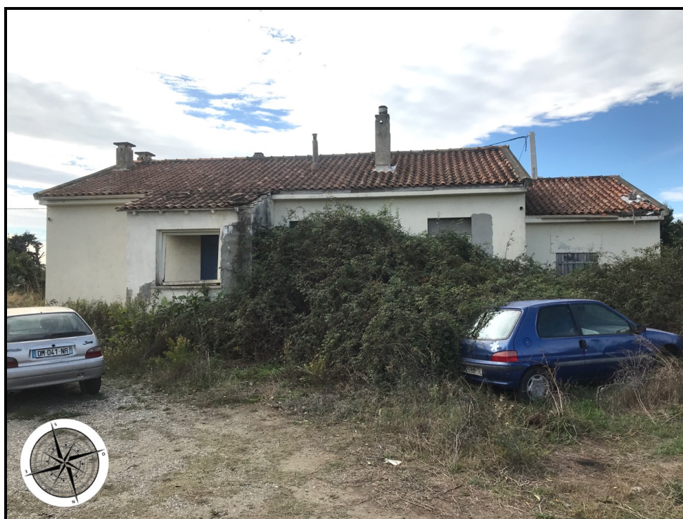
Photographie n°9. Villa non- hors d'air à l'état de ruine. Bien n°1: vue generale du toit: mauvais état apparent
