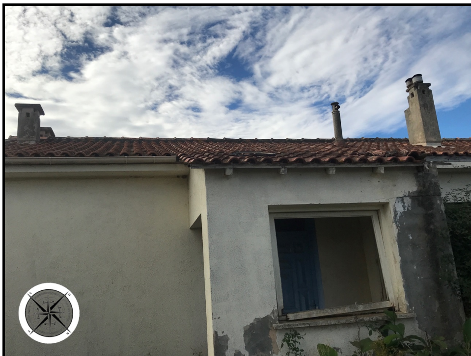
Photographie n°26. Villa non- hors d'air à l'état de ruine. Bien n°1
