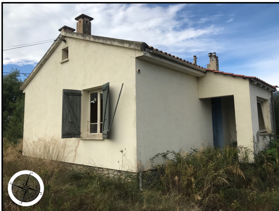
Photographie n°8. Villa non- hors d'air à l'état de ruine. Bien n°1
