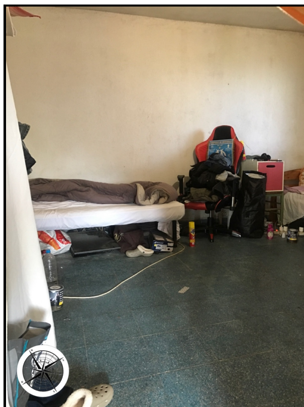
Photographie n°177. Chambre 1: sol: carrelage bleu en mauvais état
