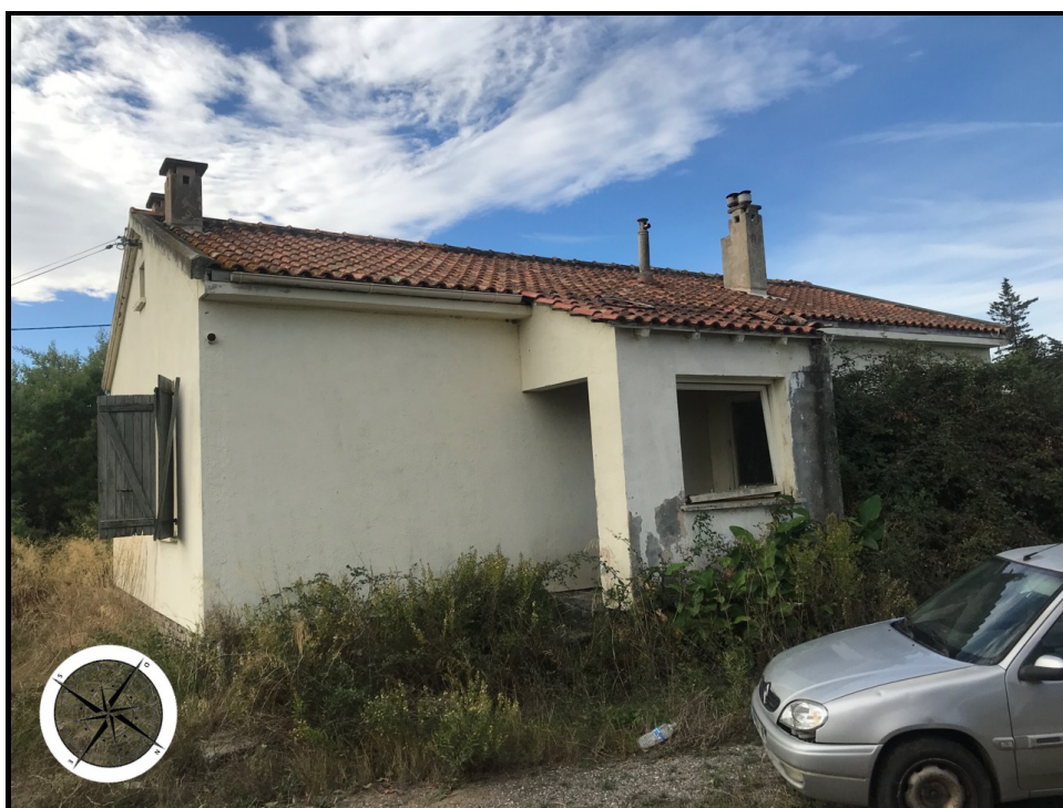
Photographie n°27. Villa non- hors d'air à l'état de ruine. Bien n°1
