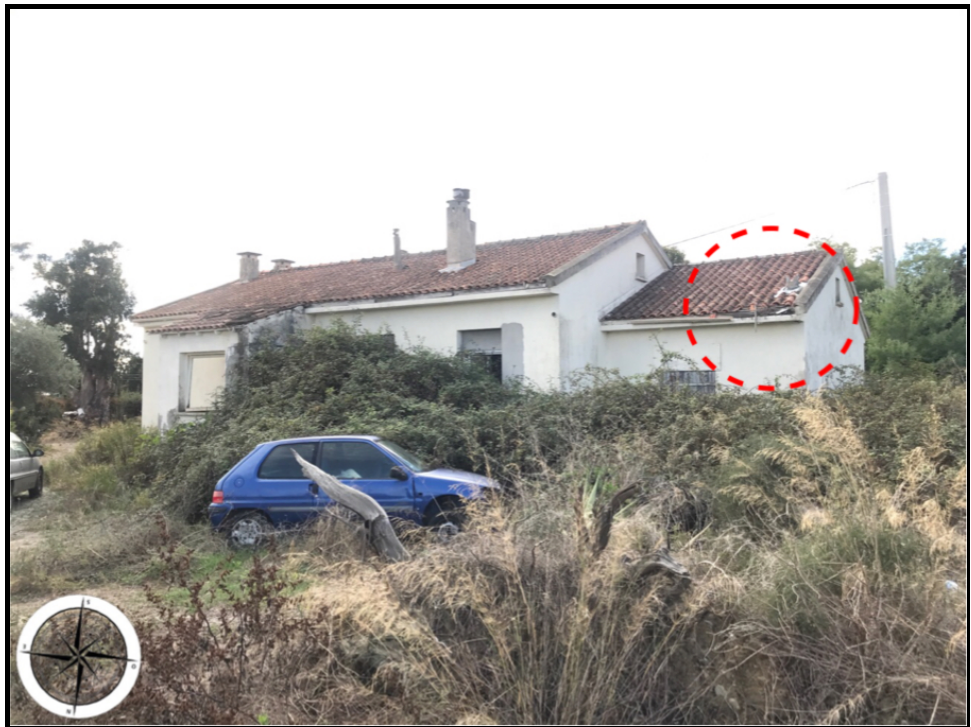
Photographie n°12. Villa non- hors d'air à l'état de ruine. Bien n°1
