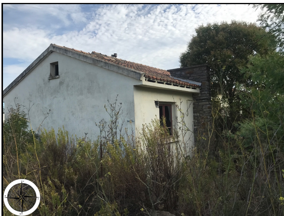
Photographie n°23. Villa non- hors d'air à l'état de ruine. Bien n°1
