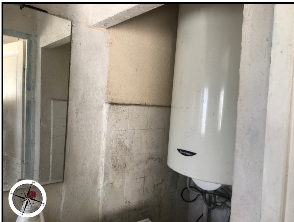
Photographie n°174. Salle d'eau et wc: cumulus
