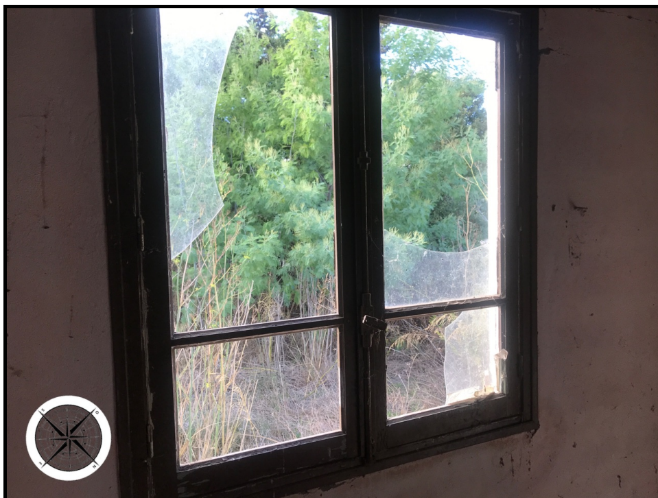
Photographie n°64. Vue huisserie (état pouvant être généralisé)
